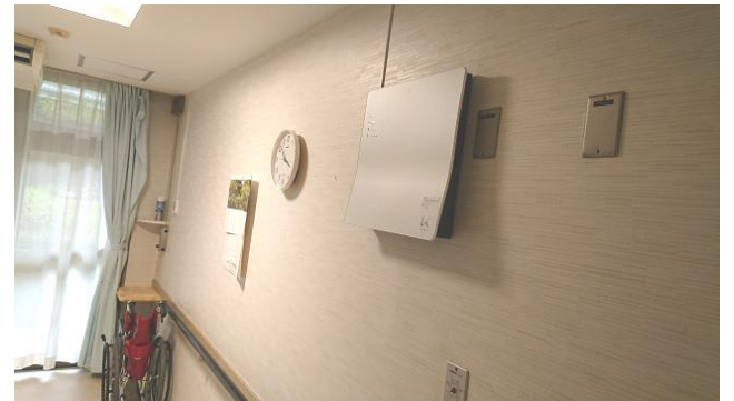
(各居室に設置したウイルス用空気清浄機)
